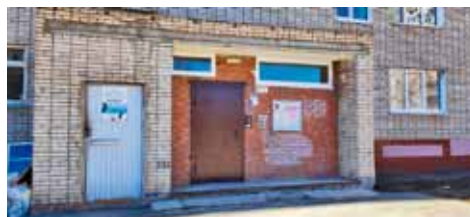
Фасад дома до ремонта
